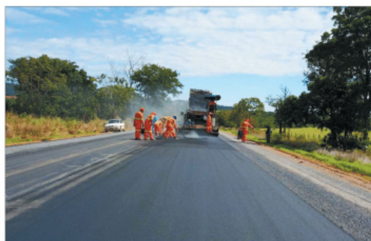
Fiscalização apontou irregularidades em 84% dos 912 km escolhidos e edificados pela antiga Agetop, no Programa Rodovias
